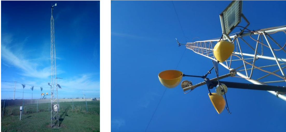
Figura 3 – Protótipo instalado na estação meteorológica da UTFPR de Londrina. A imagem da esquerda mostra a estação completa, e a da direita mostra a perspectiva do protótipo com o instrumento a 10 m.
